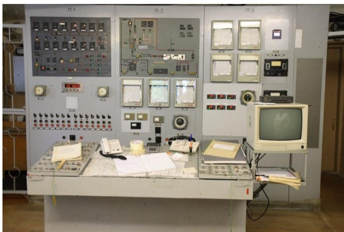
Рисунок 7- Пульт управления установки битумирования
